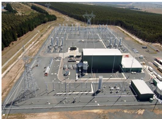
Abbildung 1 – Exemplarische HGÜ-Umrichterstation Bildquelle: www.siemens.com/presse
